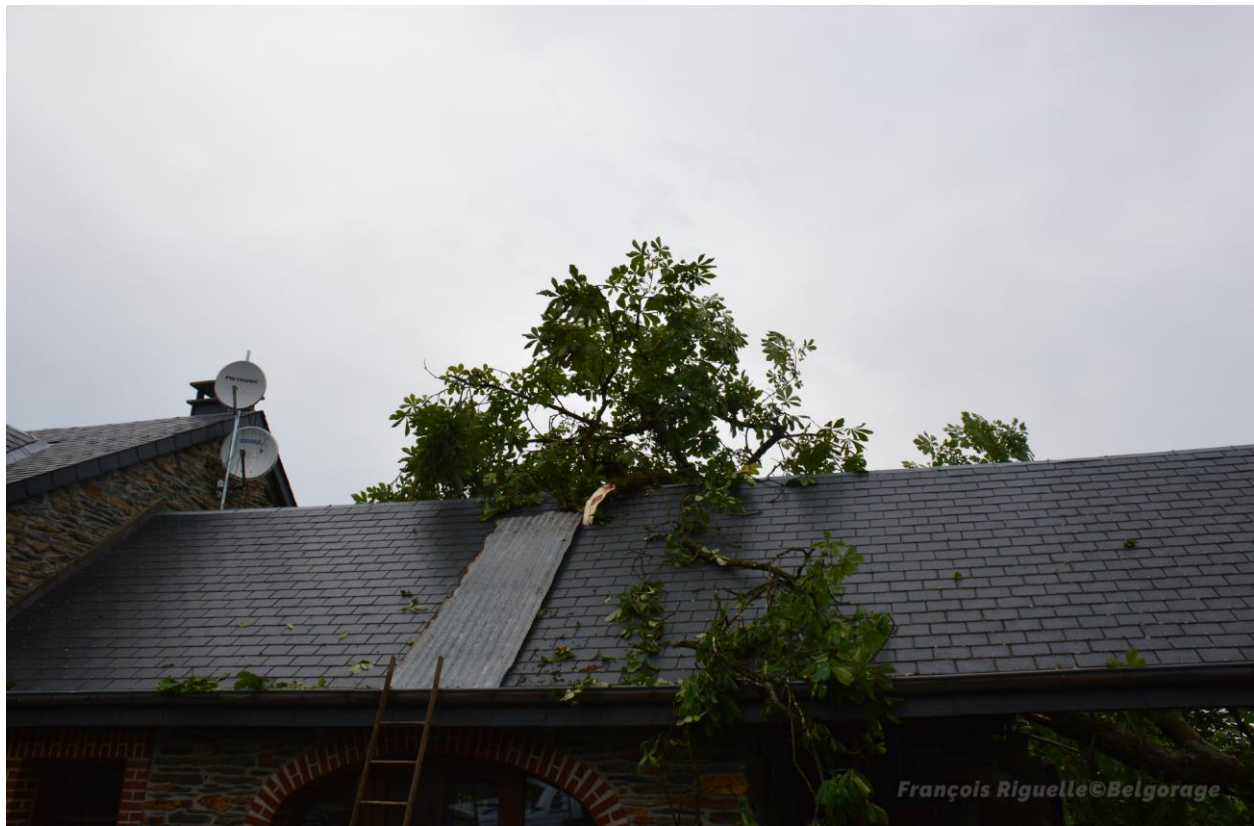
Sur la toiture du bâtiment en partie effondré, des branches du marronnier sont venues s'y loger tout comme une tôle issue de l'hangar décoiffé.
