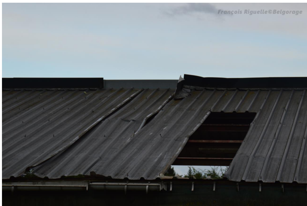
Dégâts observés sur la toiture d'une étable au hameau Les Mouches.
