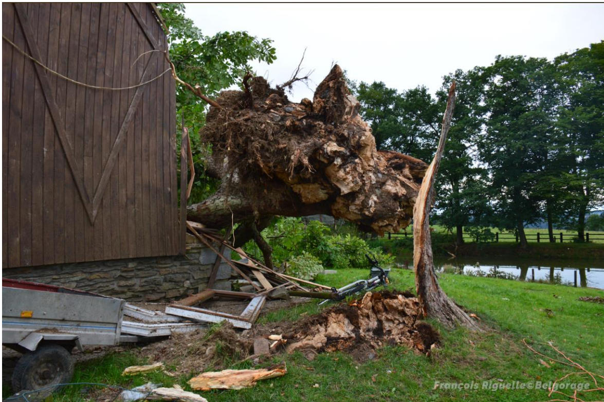
Marronnier brisé à la base et couché sur un bâtiment en l'écrasant au passage.
