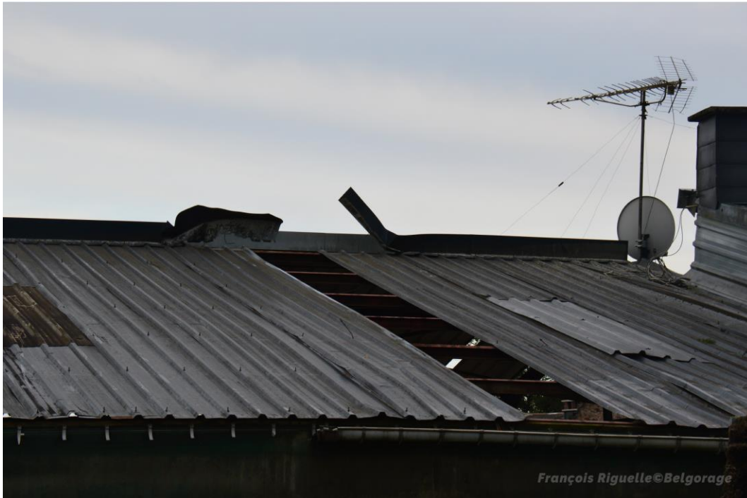
Tôles arrachées sur la toiture d'un hangar agricole.
