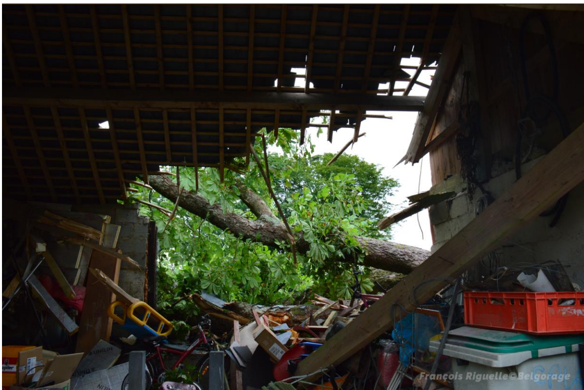
Vue de l'intérieur du bâtiment effondré à cause du marronnier abattu.
